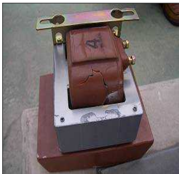
取り外して確認すると、裏側のコイルに割れがあった
