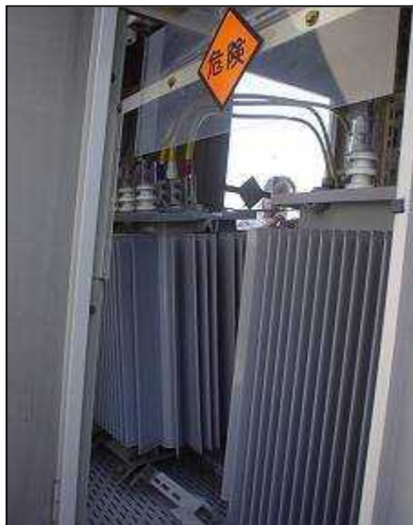
地震で傾いた変圧器
