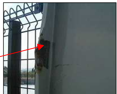
扉側蝶番が引きちぎれた跡
