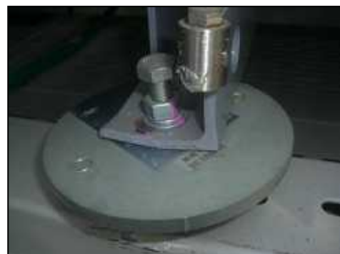
45度近く回転してしまった防振ゴム
