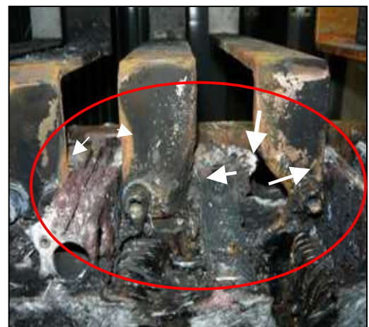
焼損MCCB電源側拡大
