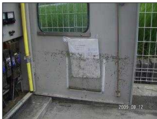
冠水したキュービクル
