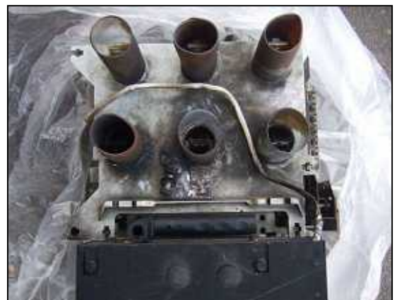
損傷したVCB
