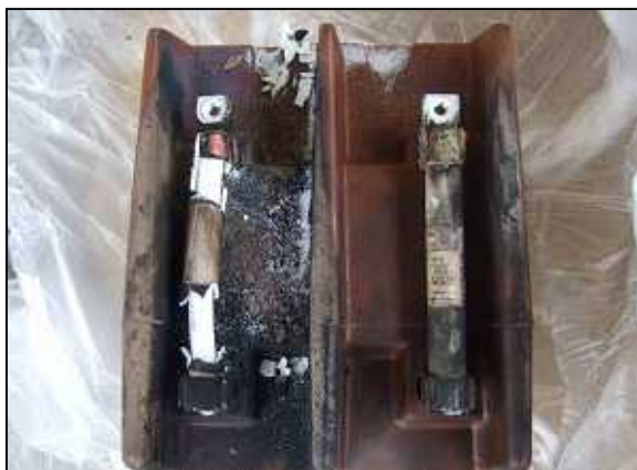
損傷したVT
