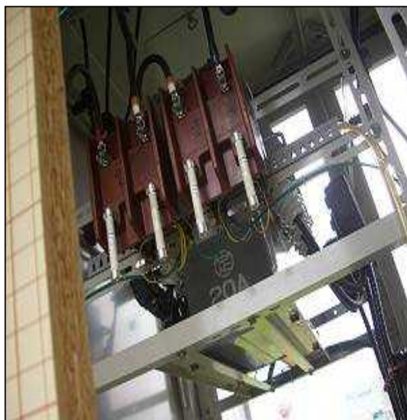
キュービクルに取付された状態
