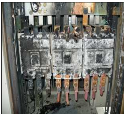
焼損MCCB部拡大
