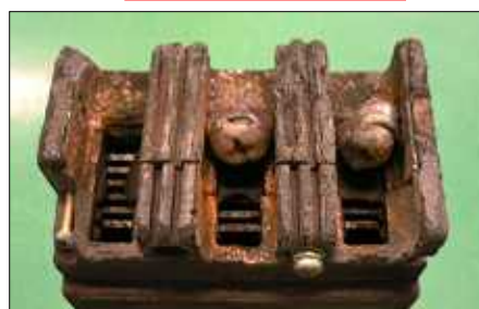
電源側 端子部拡大
