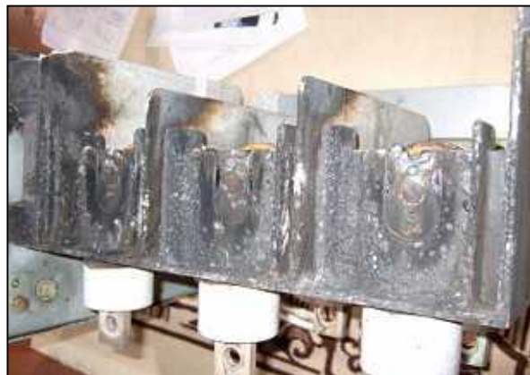
焼損したVCB(本体側面)
